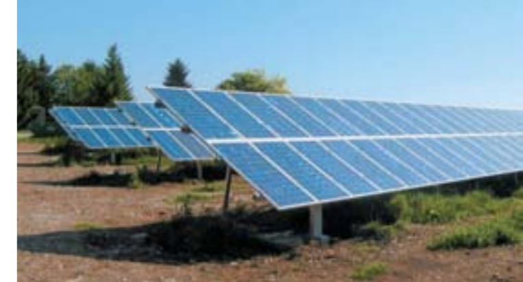
Solarpark Kaufbeuren: Mit Solaranlagen setzen wir auf unerschöpfliche und umweltgerechte Energieressourcen.
